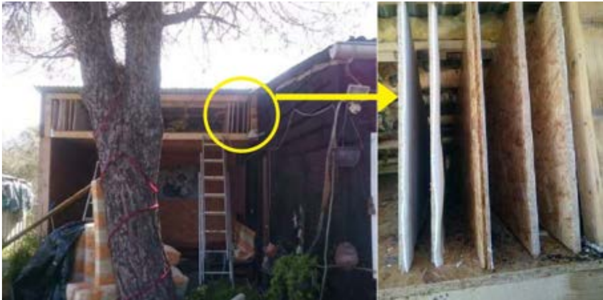
Photo 9. Réalisation d'un faux plafond avec anfractuosités pour les espèces fissuricoles (© SFEPM et LPO)
